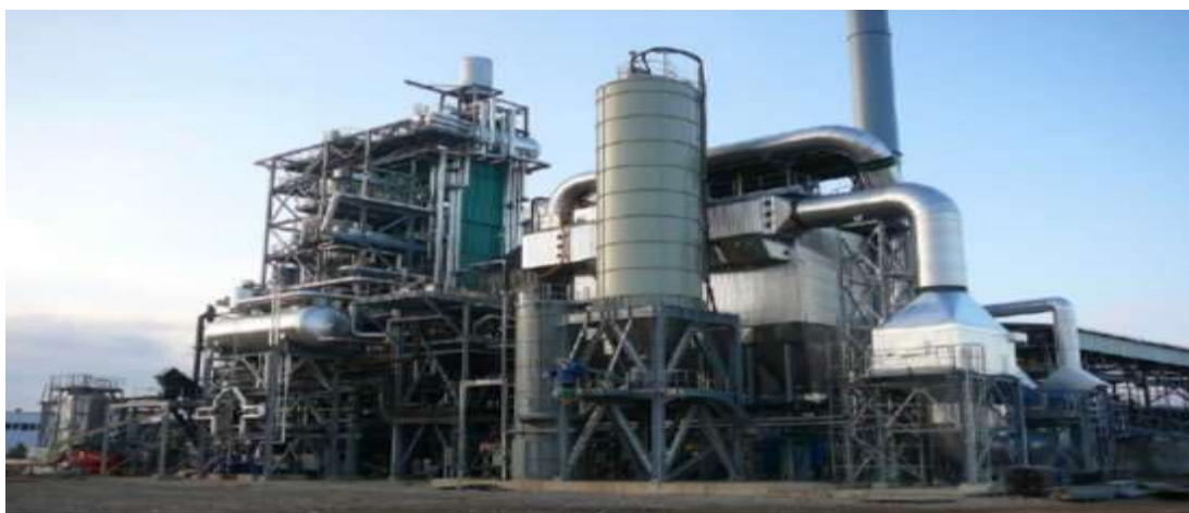
Centrale de cogénération biomasse – Foggia (Italie)
